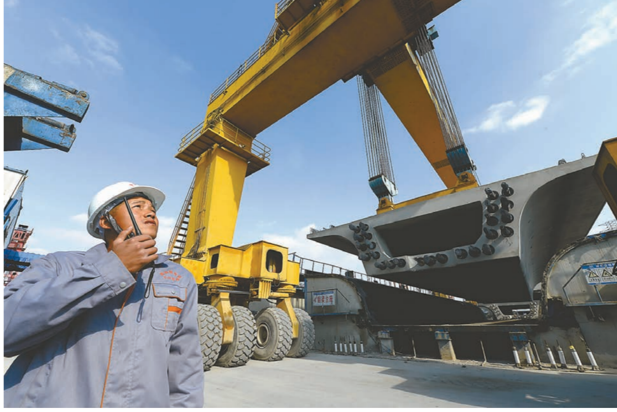
11月11日下午,中铁四局徐盐铁路8标建湖制梁场内,工人正指挥一台900吨的轮式搬运机将验收合格的箱梁搬运至提梁上桥区,被吊起的单个箱梁重达714吨。中铁四局徐盐铁路8标建湖制梁场主要承担着徐盐铁路781孔箱梁的预制和架设任务。自开工以来,预制梁完成550孔,完成率70.4%;箱梁架设完成476孔,完成率60%。全部箱梁架设工作分四批次进行,目前正在进行第三批次的架设。剩余箱梁预计在明年5月份完成架设工作。
